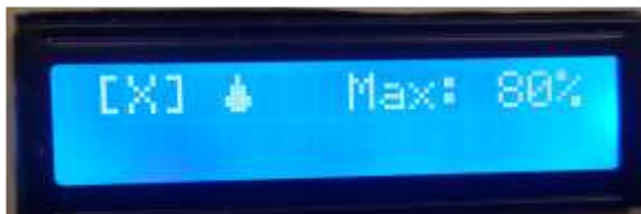
Рис. 10. Настройка реле влажности
